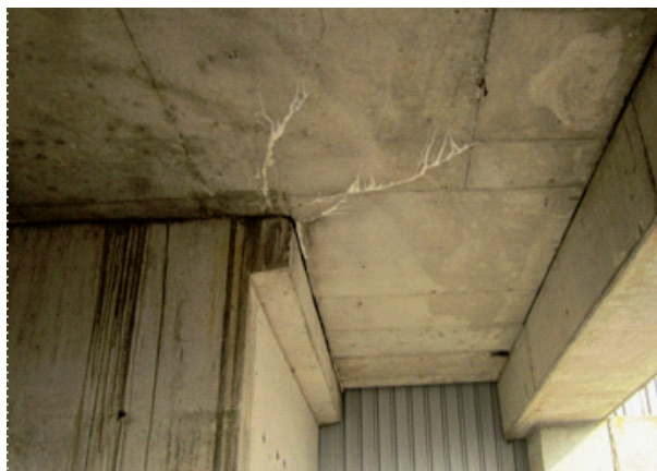
Рис.6. Тріщини а і б в плиті біля осі Г/6.
