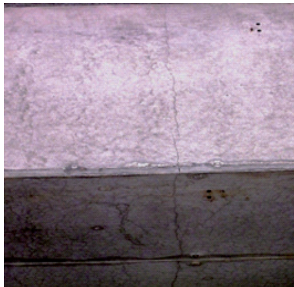
Рис.7. Тріщина ж на балці по осі 7.
