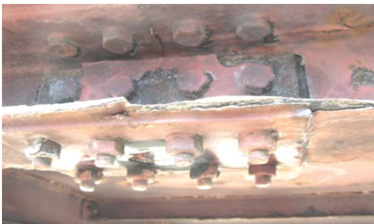
Рисунок 5 – Стан дефектного монтажної стику нижньої балки (поясу) просторової ферми. Шарувата корозія поширення нижньої полиці та нижніх і бічних накладок. Корозійне ураження метизів
