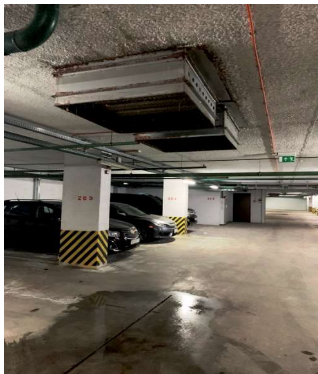
Рисунок 3 – Протікання, замокання, височини на поверхні переkritтя паркінгу навколо вентиляційної шахти та шахти димовидалення, замокання підлоги та застій води
