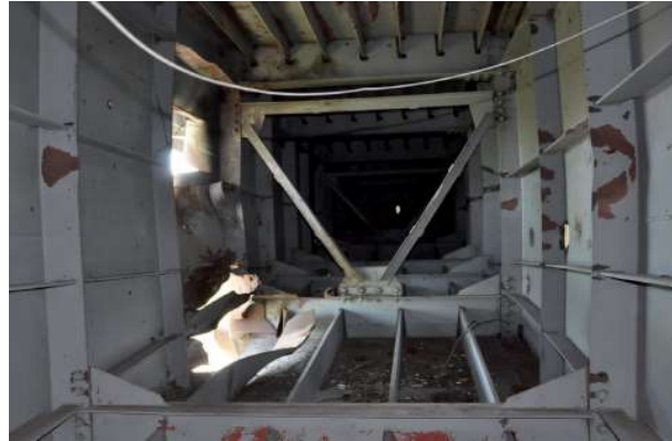
Рисунок 9 – Деформація елементів металевої балки мосту внаслідок вибуху
