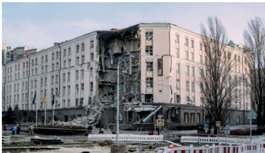
Рисунок 4 – Пошкодження будівлі готелю від вибуху ракети
