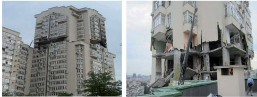
Рисунок 3 – Пошкодження монолітно-каркасного житлового будинку від вибуху ракети
