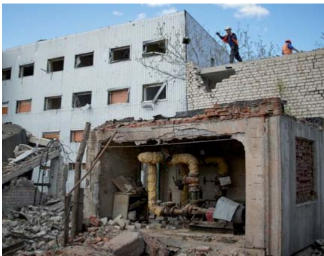
Рисунок 1 – Пошкоджений будинок з тепловим пунктом (фото з відкритих джерел)
