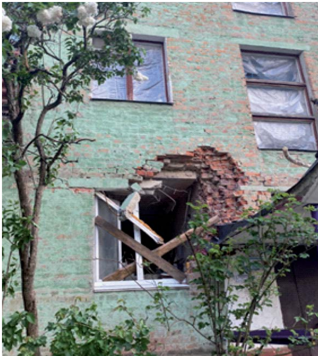
Рисунок 5 – Локальні пошкодження житлового будинку по вул. Старобілоуська, 35
