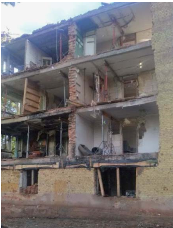
Рисунок 9 – Часткові пошкодження та руйнування конструкцій житлового будинку по вул. Ремісника, 55а
