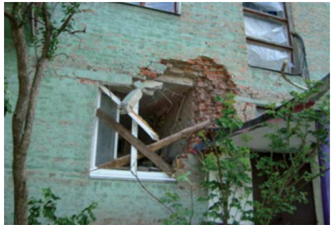
Рисунок 2 – Локальні пошкодження конструкцій житлового будинку по вул. Толстого, 142
