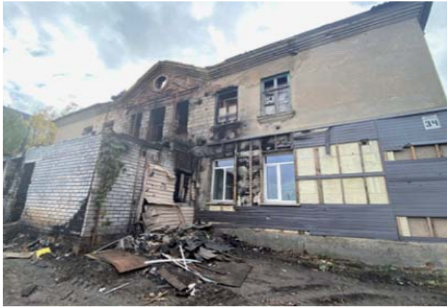
Рисунок 7 – Часткові пошкодження та руйнування конструкцій житлового будинку по вул. Любецька, 34
