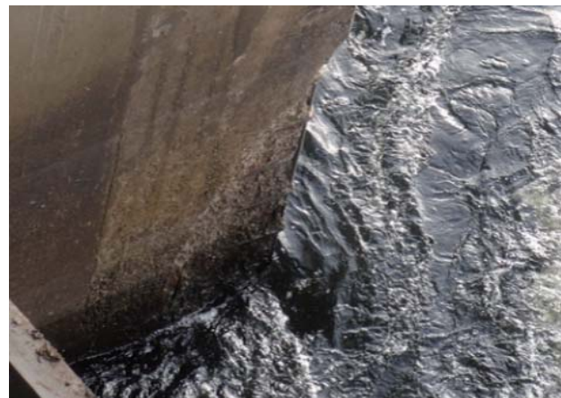
Рисунок 8 – Локальне оголення та корозія арматури опори №1
