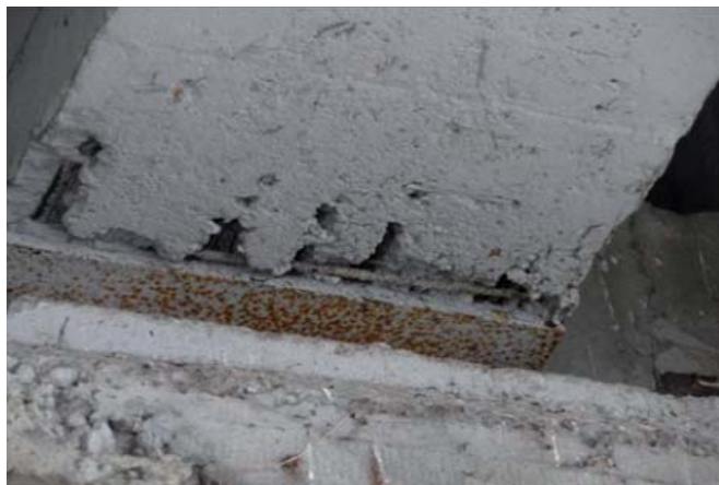
Рисунок 7 – Чисельні раковини у розтягнутій зоні бетону (прогін № 6-7)
