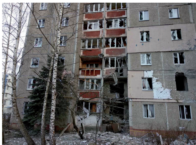
Рисунок 3 – Пошкодження житлового будинку серії АПВС ЧН-94 внаслідок артилерійського обстрілу
