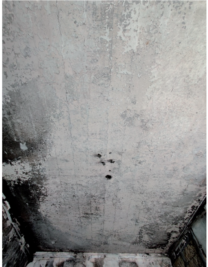
Рисунок 11 – Пошкодження захисного шару бетону панелі перекриття після пожежі
