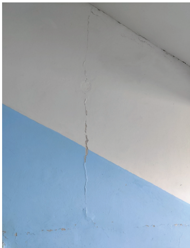
Рисунок 7 – Пошкодження заповнення стиків міжквартирних стінових панелей
