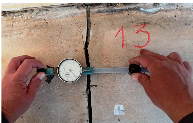
Рисунок 12 – Спостереження зміни ширини розкриття тріщин приладом «SDM50/500»
