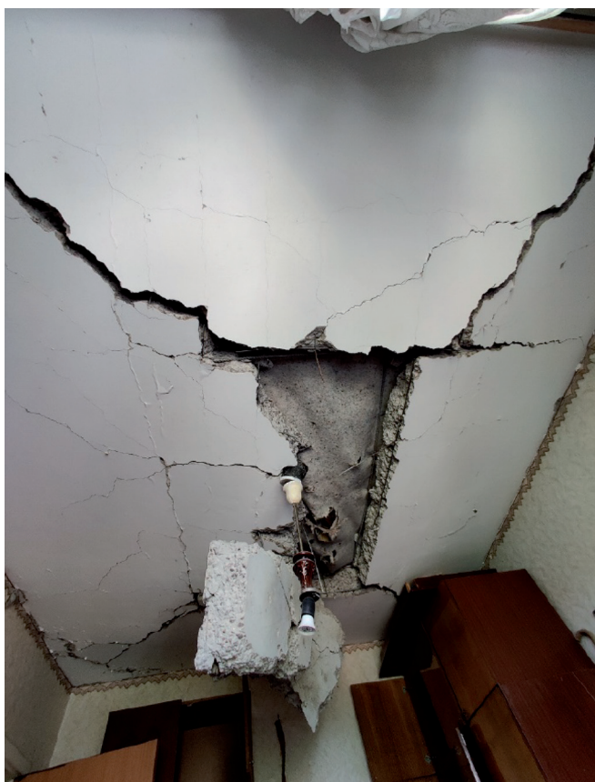
Рисунок 9 – Руйнування панелі перекриття вибуховою хвилею
