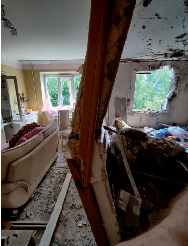
Рисунок 10 – Пошкодження зовнішньої і внутрішньої стінових панелей боєприпасами
