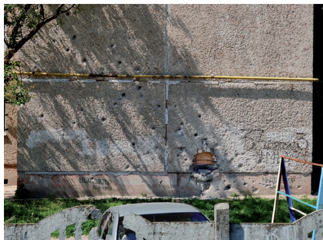
Рисунок 8 – Пошкодження захисного шару зовнішньої стінової панелі (ліва панель)
