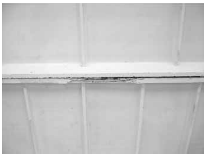
Рис.10. Руйнування захисного шару бетону плити з оголенням арматури в поздовжньому ребрі.
