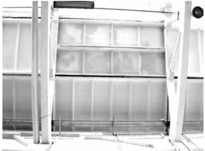
Рис.6. Зволоження конденсатом нижньої поверхні полицок плит по скату даху.
