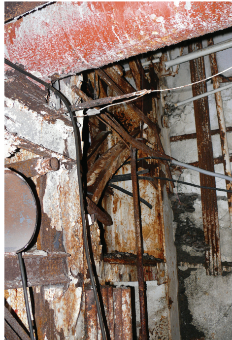
Рис.2. Корозійні пошкодження та викривлення елементів в колоні, що знаходиться в експлуатації.
