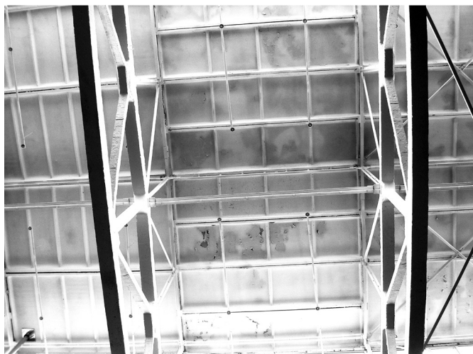
Рис.9. Зволоження конденсатом нижньої поверхні полицок плит у покритті ліхтаря.
