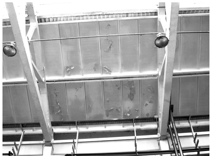
Рис.7. Початок відшарування водоемульсійної фарби від зволоженого бетону полицок.
