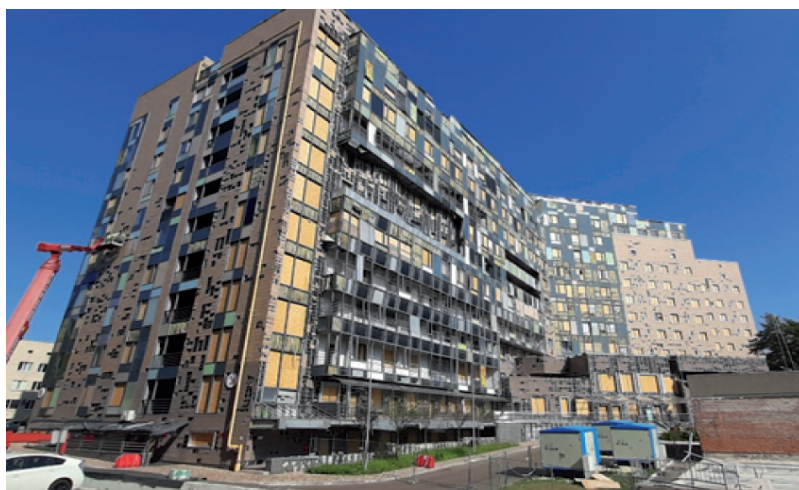
Рисунок 2 – Загальний вигляд будівлі НДСЛ «Охматдит» зі сторони вибуху
