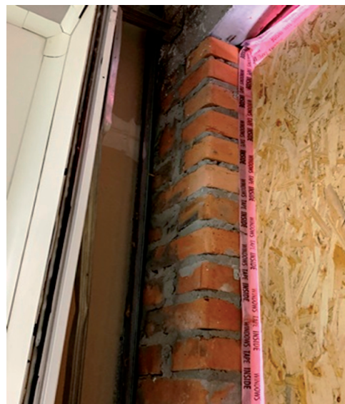
Рисунок 7 – Викривлення стіни у вертикальній площині до 43 мм, відрив дюбелів кріплення направляючих для гіпсокартону в осях 3в-4в/Кв на позначці +18,600
