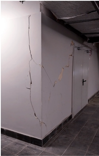
Рисунок 4 – Пошкодження стіни із газоблоків в осях 3в/Кв-Жв на позначці +29,700 (блок В)
