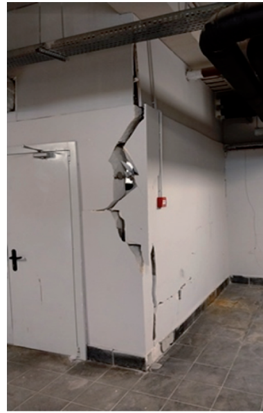
Рисунок 5 – Руйнування стіни із газоблоків з зсувом із площини в осях 6в/Кв-Жв на позначці +29,700 (блок В)
