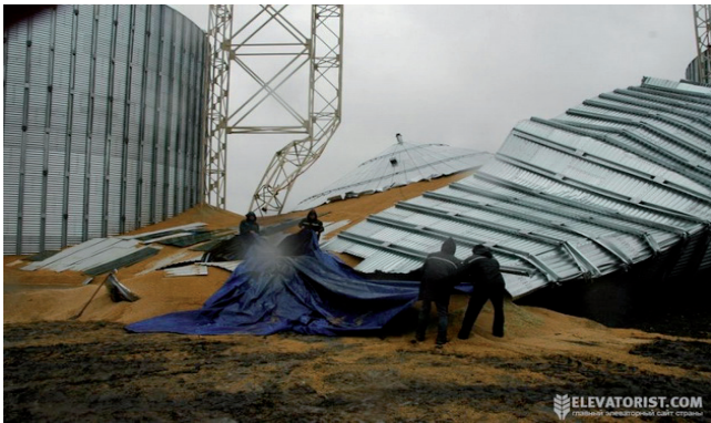
Рисунок 4 – Руйнування зернового силосу
