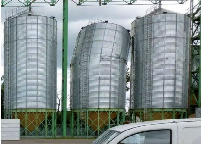
Рисунок 2 – Деформування стінок силосу
