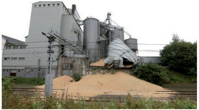
Рисунок 5 – Руйнування зернового силосу
