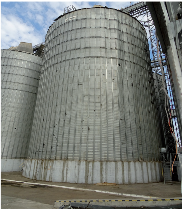
Рисунок 6 – Деформування стінок силосу від вибухової хвилі
