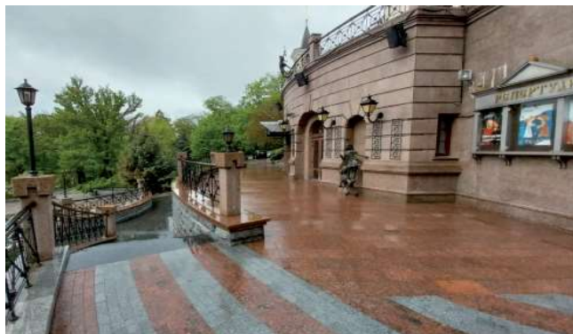
Рисунок 8 – Загальний вигляд будівлі театру (а) та тераса головного входу в осях В'-И (б)
