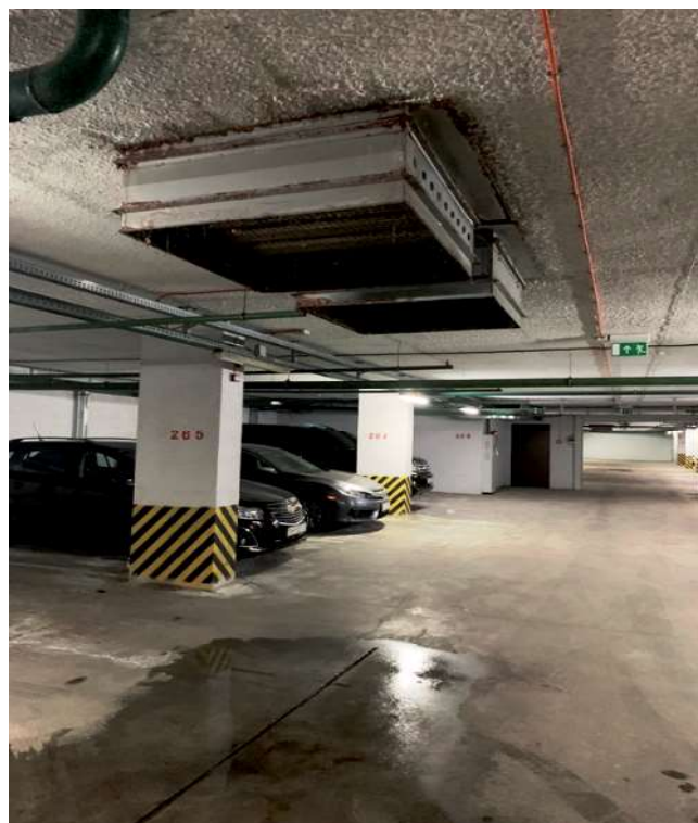
Рисунок 3 – Протікання, замочання, висоли на поверхні переkritтя паркінгу навколо вентиляційної шахти та шахти димовидалення, замочання підлоги та застій води
