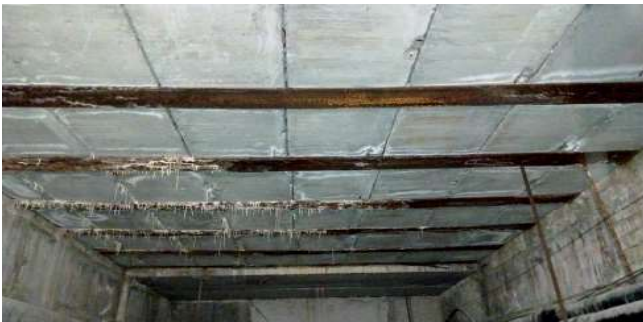
Рисунок 7 – Сліди протікання по швах між плитами перекриття тераси секції I і на стіні підвалу, вапнякові утворення
