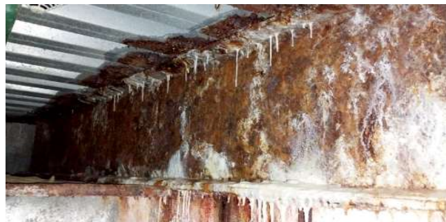
Рисунок 10 – Пластова корозія металевої балки з двох двотаврів N 45, наскрізна корозія профнастилу, вапнякові утворення
