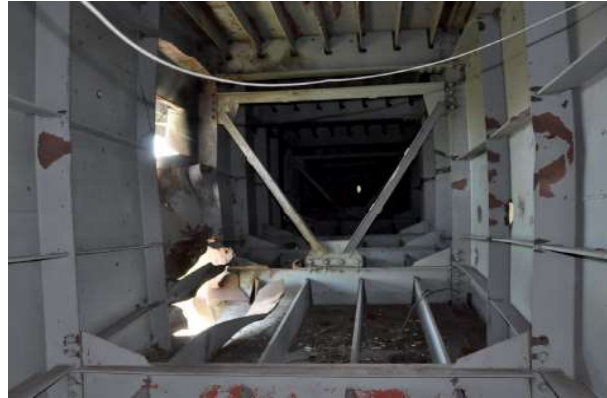
Рисунок 9 – Деформація елементів металеві балки мосту внаслідок вибуху
