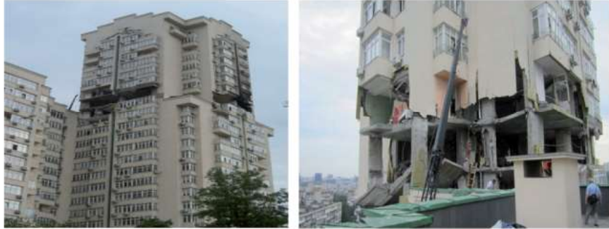
Рисунок 3 – Пошкодження монолітно-каркасного житлового будинку від вибуху ракети
