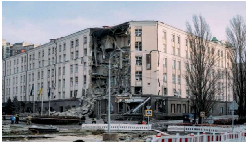
Рисунок 4 – Пошкодження будівлі готелю від вибуху ракети
