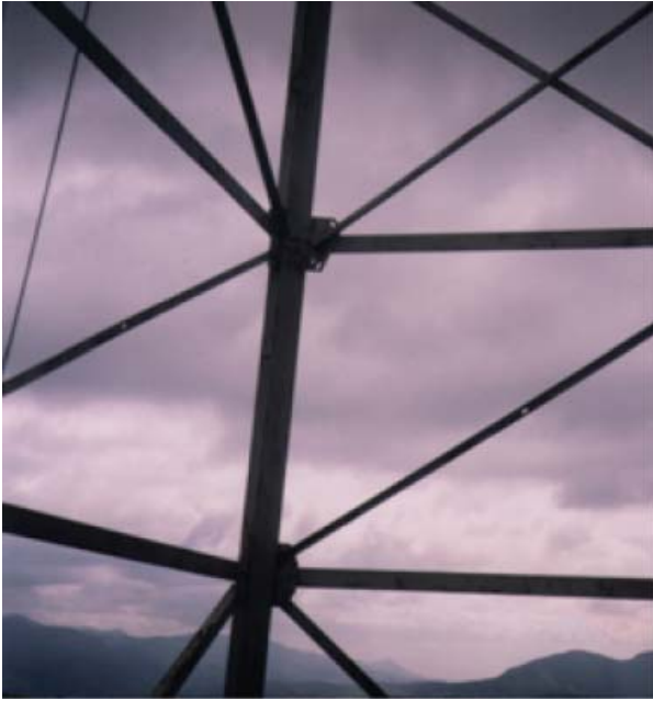
Рисунок 4 – Дефекти конструктивних елементів решітки вежі
