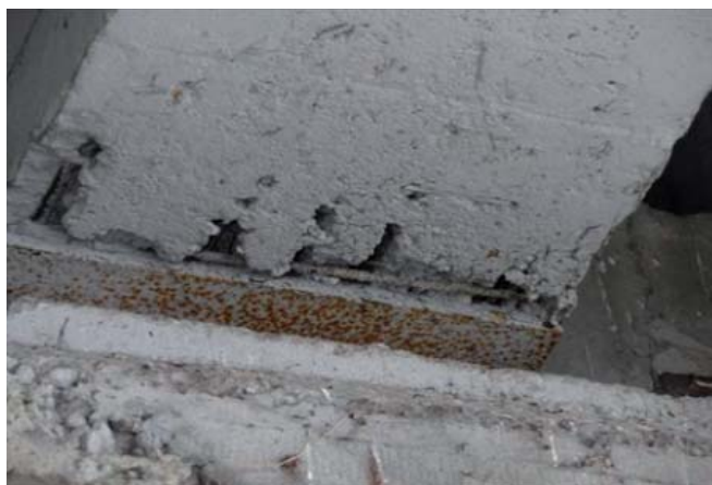
Рисунок 7 – Чисельні раковини у розтягнутій зоні бетону (прогін № 6-7)
