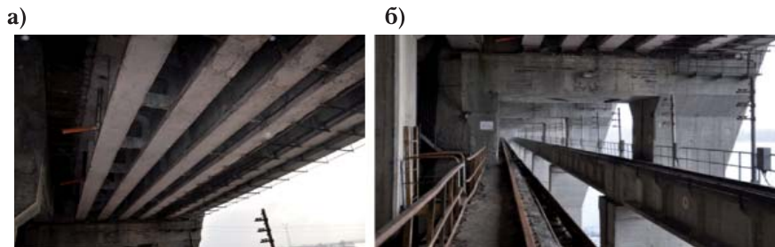
Рисунок 3 – Вид знизу: а) на прогони № 1-2 та б) монолітні П-подібні залізобетонні опори, суміщені з биками будівлі ГЕС
