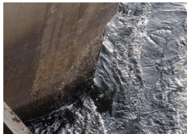
Рисунок 8 – Локальне оголення та корозія арматури опори №1
