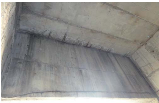
Рисунок 5 – Сліди замокання та вилугування бетону, пошкодження захисного шару бетону із оголенням арматури
