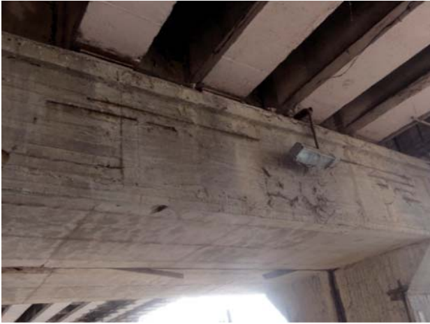
Рисунок 9 – Оголення та корозія арматури ригеля опори № 2
