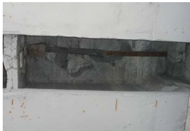
Рисунок 6 – Сколювання бетону із оголенням арматури, корозія арматури (прогін № 1-2)
