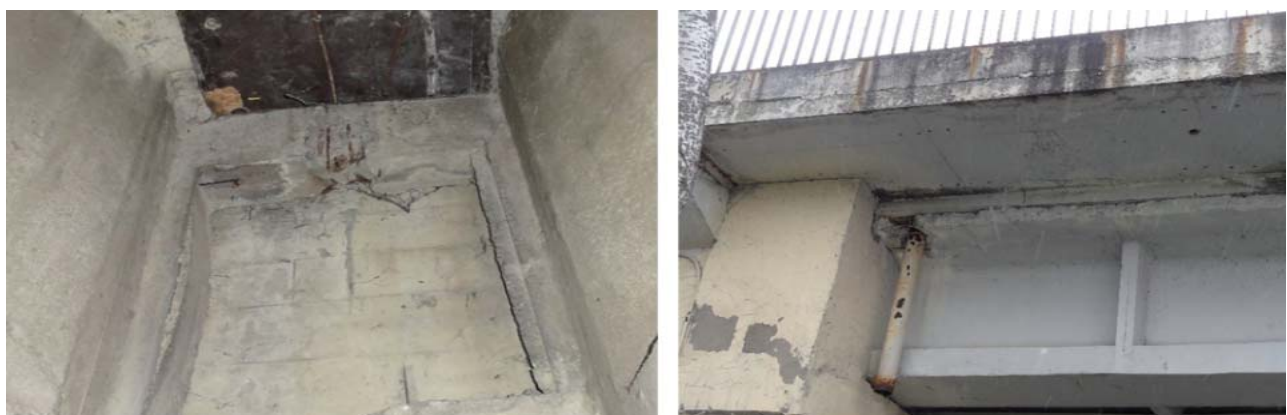
Рисунок 13 – Пошкодження захисного шару бетону у вузлі діафрагми та сколи бетону у розтягнутій зоні з оголенням арматури, корозія арматури, сліди замокання з вилугуванням бетону на торцевих частинах плити мостового полотна
