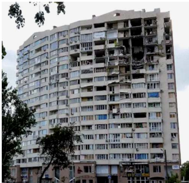
Рисунок 11 – Часткові пошкодження житлового будинку по вул. В'ячеслава Чорновола, 15а
