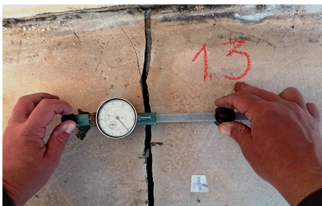
Рисунок 12 – Спостереження зміни ширини розкриття тріщин приладом «SDM50/500»
