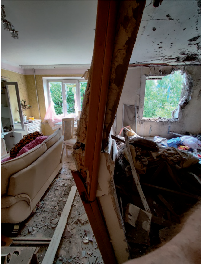
Рисунок 10 – Пошкодження зовнішньої і внутрішньої стінових панелей боєприпасами
