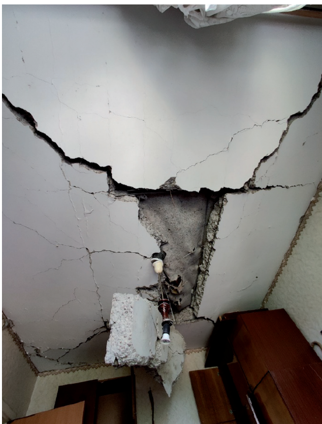
Рисунок 9 – Руйнування панелі перекриття вибуховою хвилею
