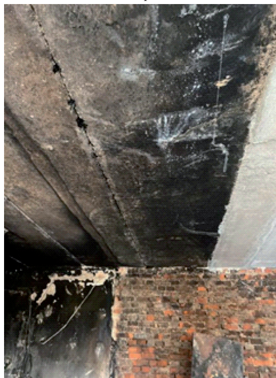
Рисунок 2 – Розшарування, вогневе пошкодження кладки від пожежі на глибину до 20 мм, кіптява на поверхні конструкцій внаслідок пожежі (3-й поверх, кв. 28)
