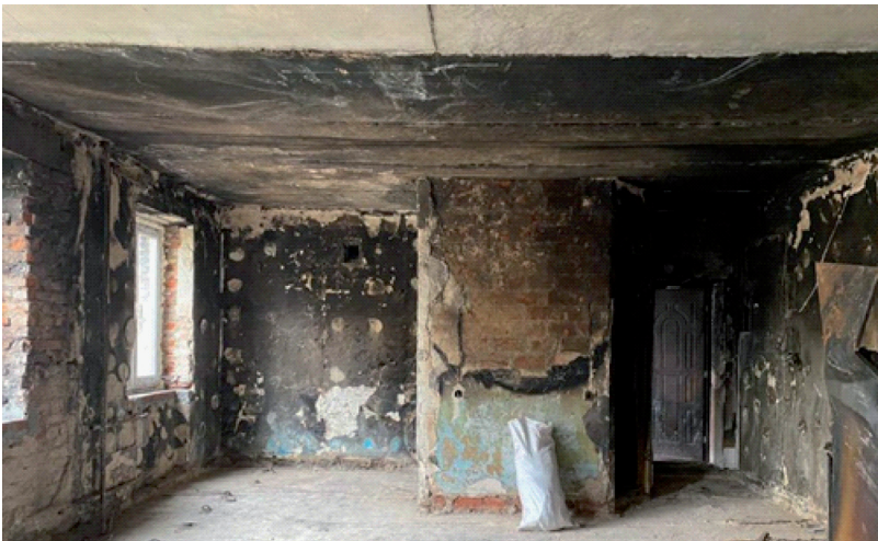
Рисунок 3 – Руйнування опорядження стін та стелі, розшарування, вогневе пошкодження кладки від пожежі на глибину до 20 мм, кіптява на поверхні конструкцій внаслідок пожежі (4-й поверх, кв. 32)
