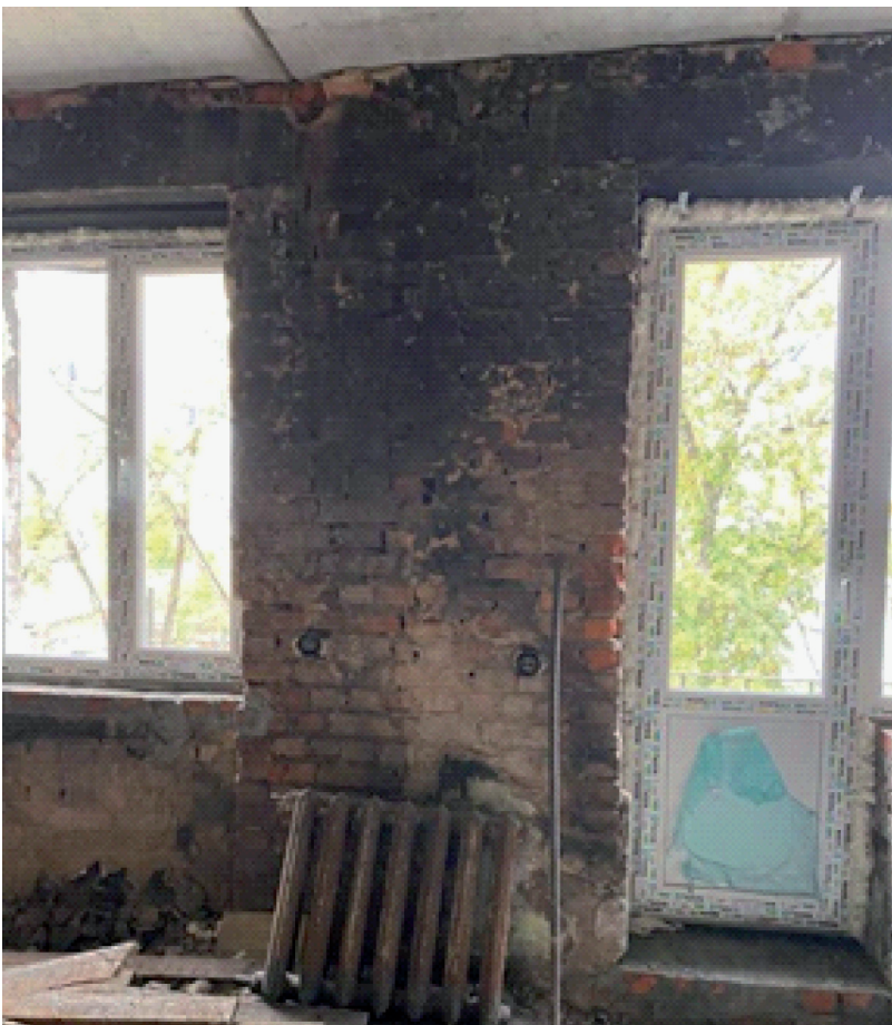
Рисунок 4 – Руйнування опорядження стін, розшарування, вогневе пошкодження кладки від пожежі на глибину до 20 мм, кіптява на поверхні конструкцій внаслідок пожежі (4-й поверх, кв. 46)
