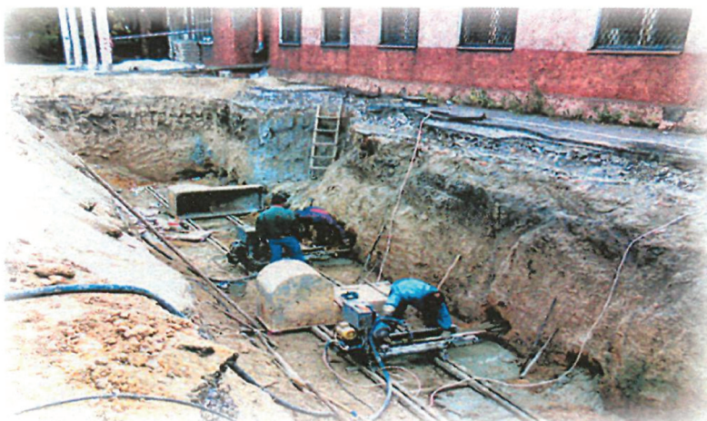
Рис.3. Усунення наднормативних кренів будинку шляхом горизонтальної підробки ґрунтової основи під подошвою фундаменту.
