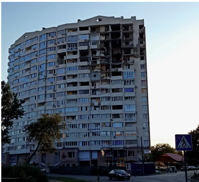
Рисунок 10 – Наслідки влучання у житловий будинок по вул. Чорновола, 15, м. Чернігів
