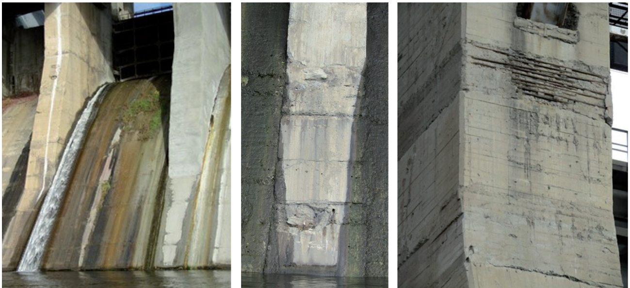
Рисунок 8 – Загальний вид на водозливну поверхню між биками № 3 і № 4. Руйнування захисного шару бетону, оголення та корозія арматури, сколи бетону биків №№ 18, 21
