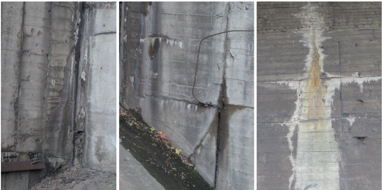
Рисунок 6 – Руйнування захисного шару бетону, тріщини шириною розкриття до 5 мм, висоли, неякісне бетонування, фільтрація (бики №№ 46, 47, 48 з боку нижнього б'єфу)
