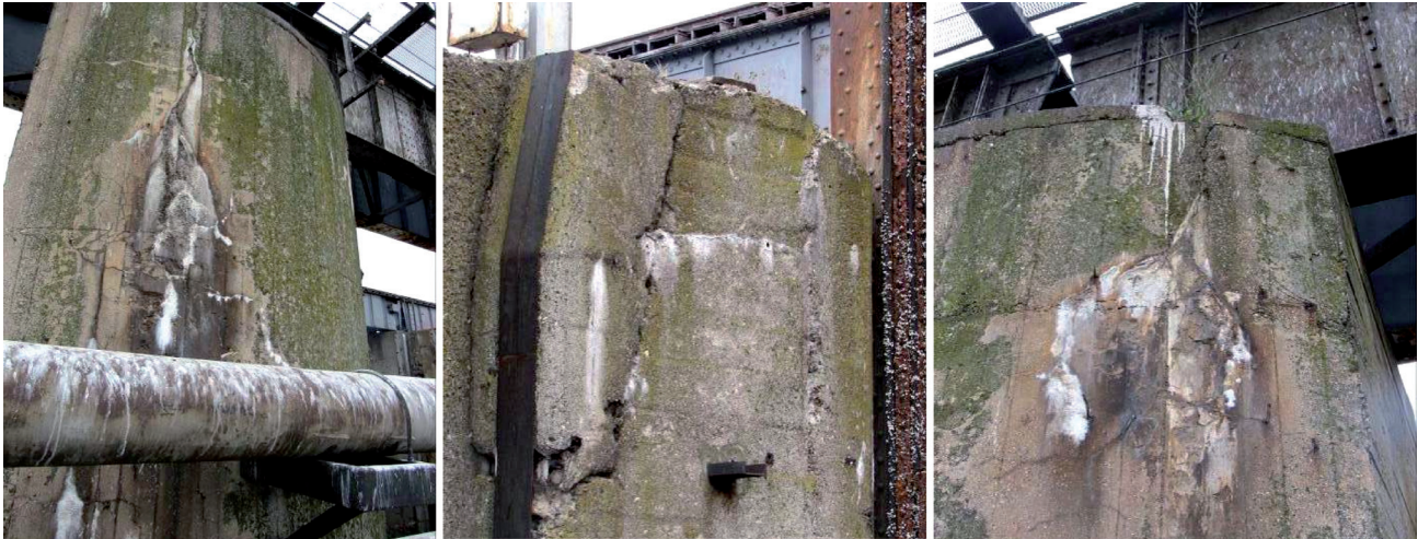
Рисунок 5 – Руйнування захисного шару бетону, оголення та корозія арматури, сколи, висоли, тріщини (відповідно бички №№ 10, 11, 12 з боку верхнього б'єфу)
