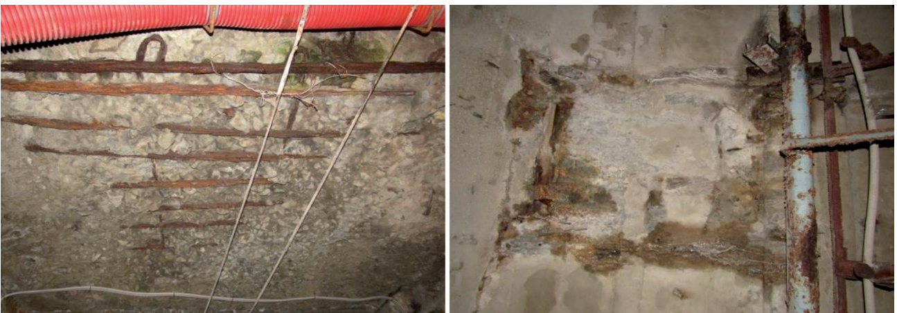
Рисунок 7 – Руйнування захисного шару бетону потерни, оголення та пластинчаста корозія арматури, сліди замкання
