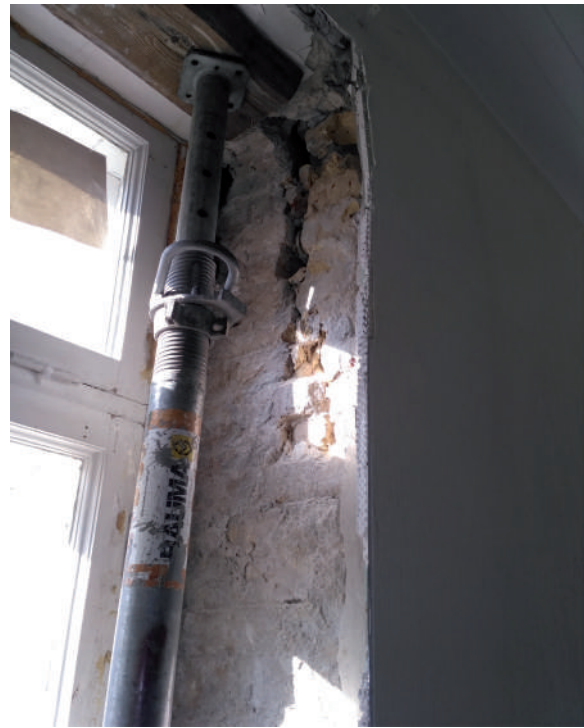
Рисунок 4 – Тріщина в простінку, яка переходить у розкол надвіконної частини стіни
