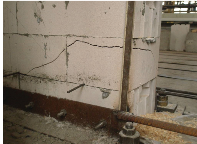
Рис.10. Характер разрушения простенка (образование и раскрытие трещин в газобетонных блоках нижних рядов кладки).
